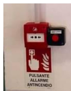
Esempio di pulsante di allarme presente in diversi punti dell'edificio.
